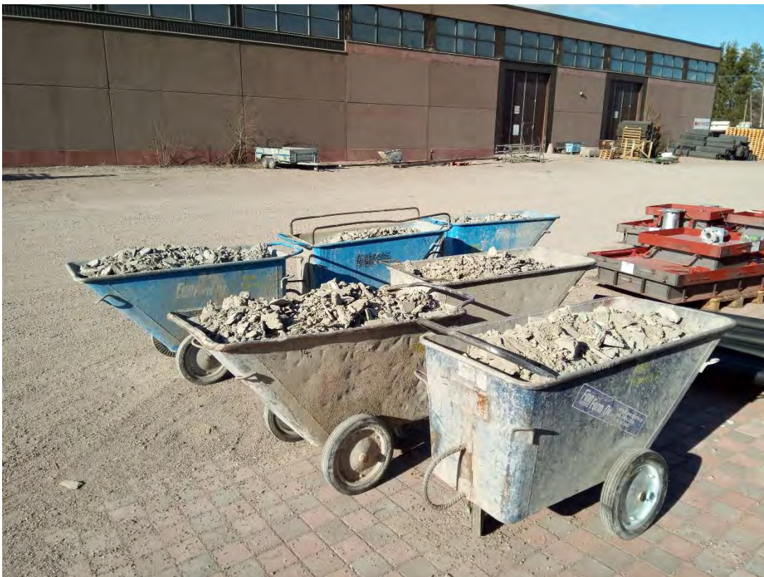
Kuva 4. Väestönsuojahallin siivousmurskeen keräysastioiden tyhjennysalue
