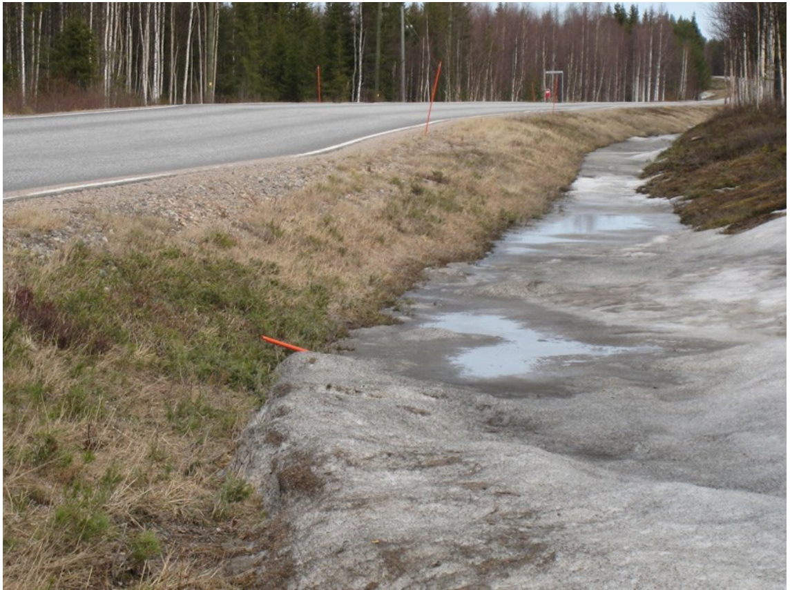
Kuva 16. Epätasainen routanousu aiheuttaa pituussuuntaisia heittoja. (ROADX, 2023)
