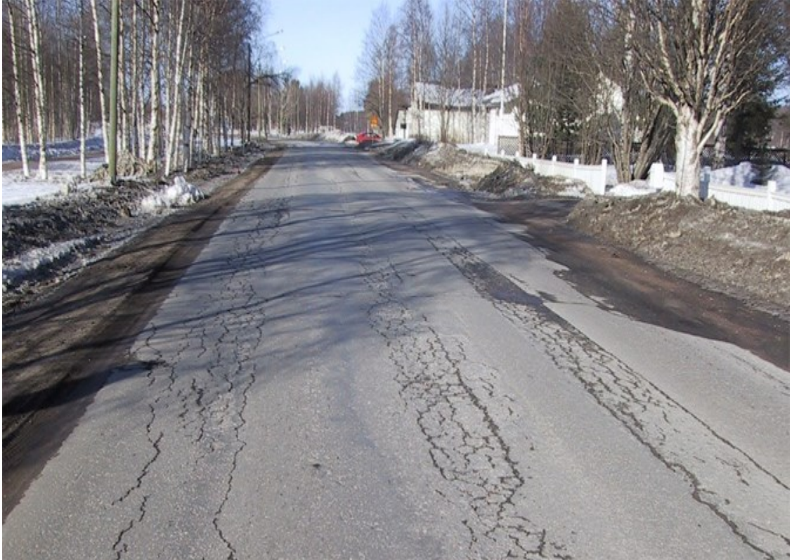
Kuva 14. Urautumisen seurauksena päällysteen pintaan on muodostunut verkko- halkeamia. (ROADEX, 2023)
