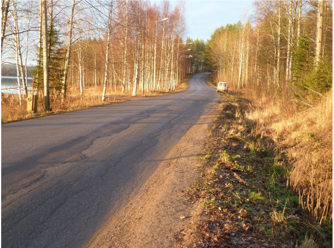
Kuva 15. Sitomattomien rakennekerrosten ja pohjamaan pysyvät muodonmuutokset näkyvät erityisesti kapeilla teillä reunojen pettämisenä. (ROADDEX, 2023)
