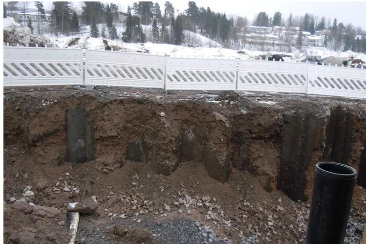
Työmaalla. Maaperän pehmeys voi aiheuttaa ongelmia pohjarakenteiden kestävyydelle. Siksi suomalaisilla rakennustyömailla maaperää joudutaan vahvistamaan. KUVA: LEEINA KORKIALA-TAINTTU / AALTO-YLIOPISTO
