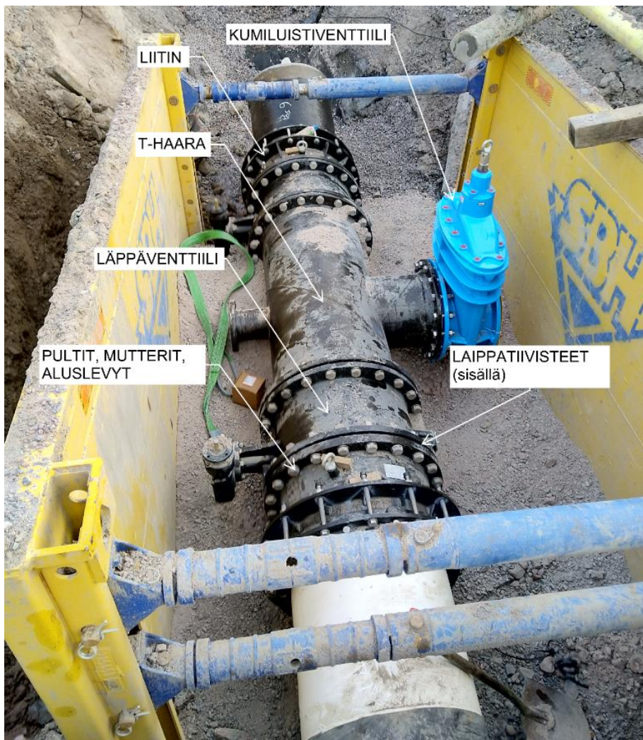
Kuva 3.1 Verkostot koostuvat putkien lisäksi erilaisista rakennusosista kuten venttiileistä, liittimistä ja erilaisista liitoksista. Erilaisten rakennusosien materiaalit tulisi huomioida aina putkien lisäksi, kun arvioidaan yhteensopivuutta UUMA-materiaalien kanssa.
