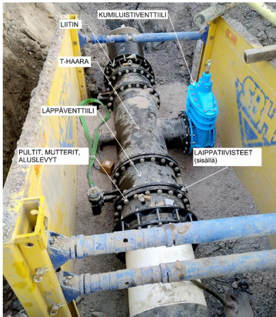
Erialaisten rakennusosien materiaalit tulisi huomioida aina putkien lisäksi, kun arvioidaan yhteensopivuutta UUMA-materiaalien kanssa.
