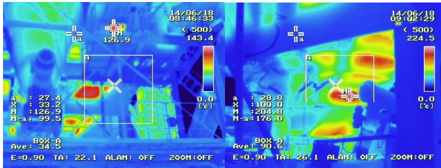
Kuva 33. Oulun aseman lämpöhäviöitä
