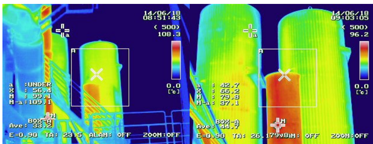
Kuva 19. Oulun aseman bitumitankin lämpöhäviöt
