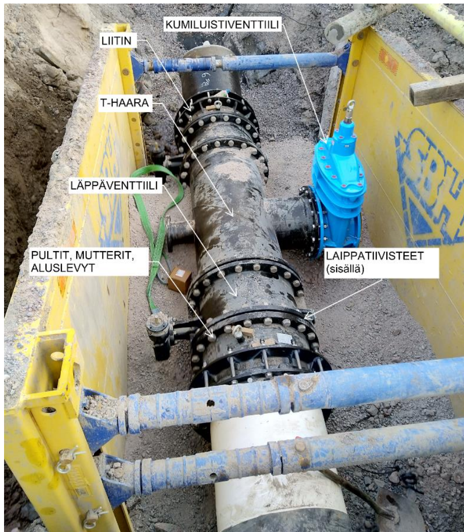
Kuva 3.1 Verkostot koostuvat putkien lisäksi erilaisista rakennusosista kuten venttiileistä, liittimistä ja erilaisista liittoksista. Erilaisten rakennusosien materiaalit tulisi huomioida aina putkien lisäksi, kun arvioidaan yhteensopivuutta UUMA-materiaalien kanssa.
