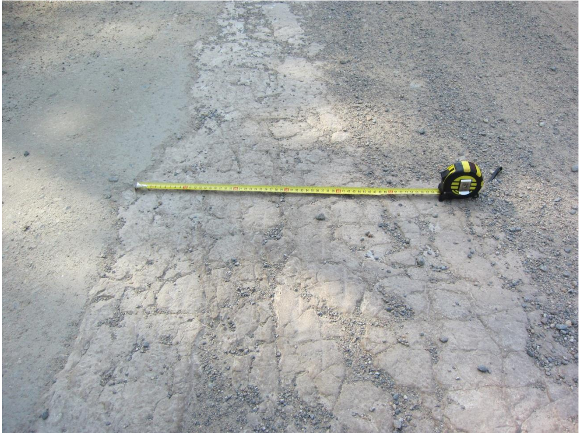
Kuva 6.45. Puutteellinen kulutuskerros Leppävirran koekohteessa paalulla 1350
