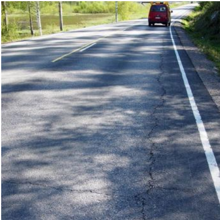
Kuva 6.21. Tiellä 16573 paalulla 3110 vuonna 2012 havaittu pituushalkeama (kuva: Kiviniemi, 2012)
