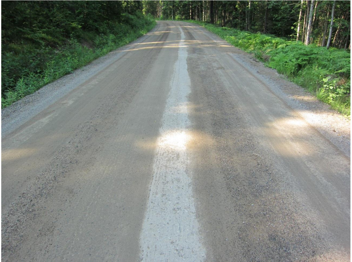
Kuva 6.37. Kukkian pilotin paalulla 8265 kerrosstabilointi on näkyvissä puutteellisen kulutuskerroksen vuoksi
