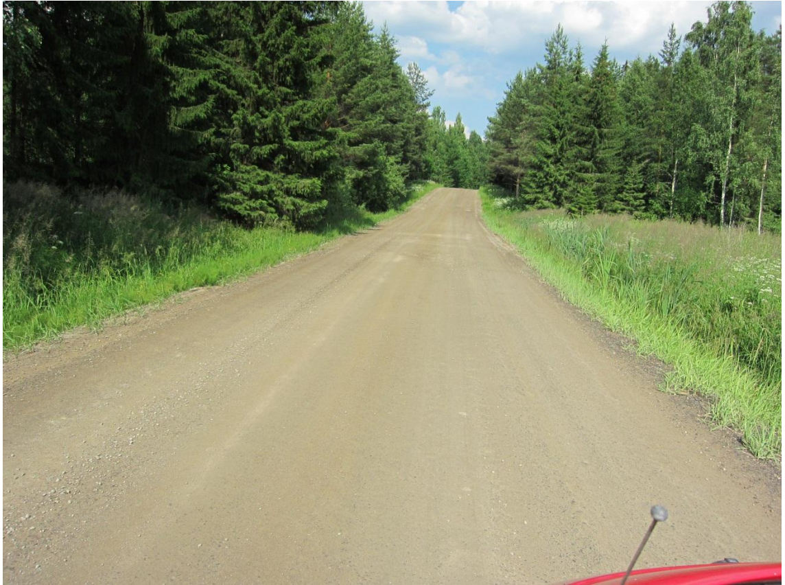
Kuva 6.36. Kukkian pilotin murskerakenteen alueelta työpaalulta 750 kesällä 2013 otettu kuva kelirikon leventämisestä tiestä
