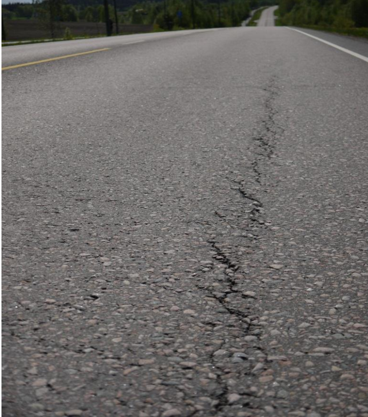
Kuva 6.17. Tiellä 16563 havaittu pituushalkeama (kuva: Mäkinen, 2013)
