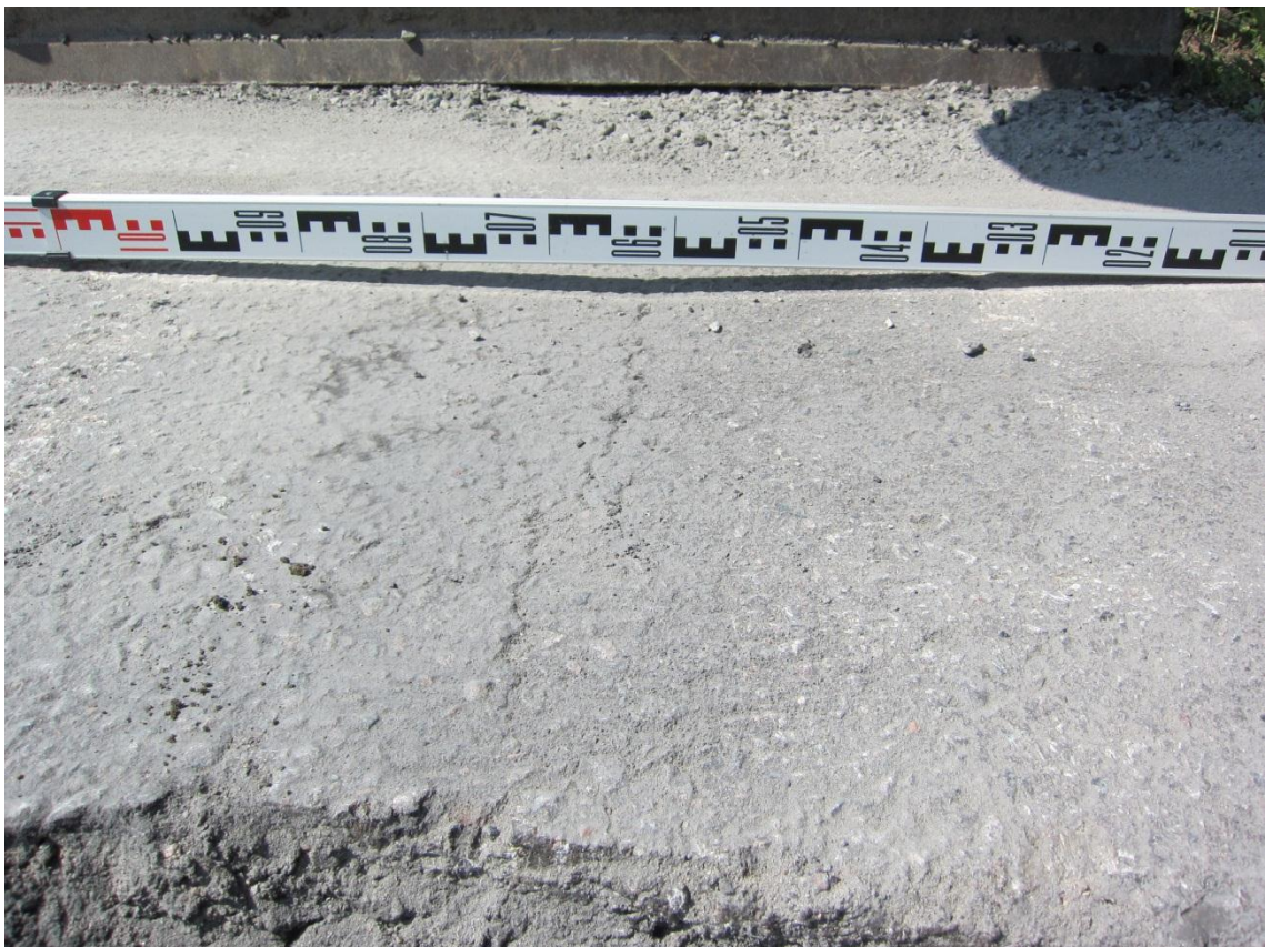
Kuva 6.7. Pohjamaan deformaation aiheuttamaa urautumista paalulta 3410.
