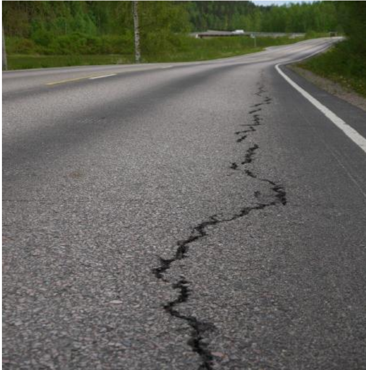
Kuva 6.20. Tiellä 16573 paalulla 3110 vuonna 2013 havaittu pituushalkeama (kuva: Mäkinen, 2013)
