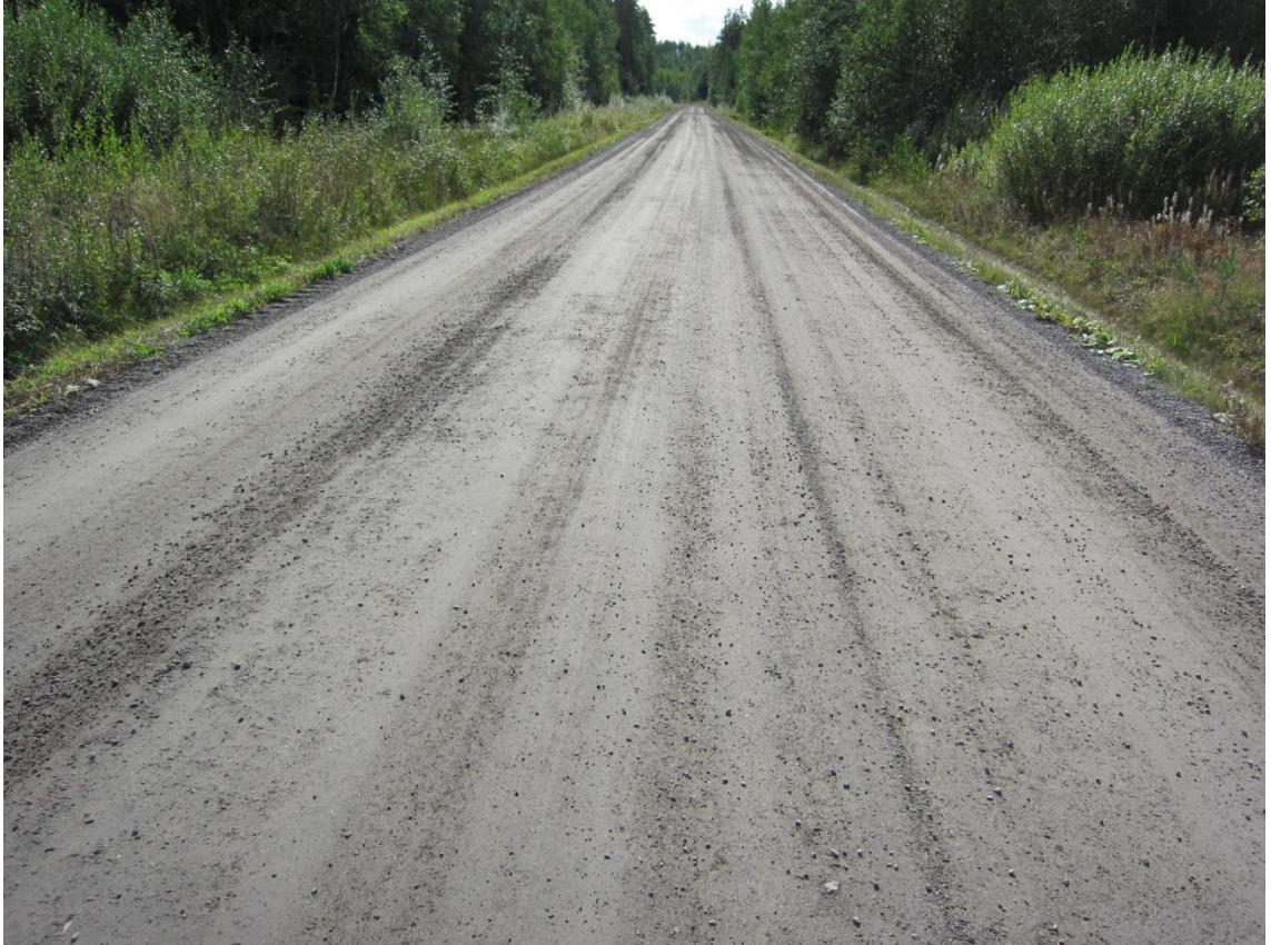
Kuva 6.29. Korian Metsäkulmantiien paalulla 1100 tuhkarakenteen 1 alueella tien vasemmassa reunassa vuonna 2013 havaittua lievää reunapainumaa
