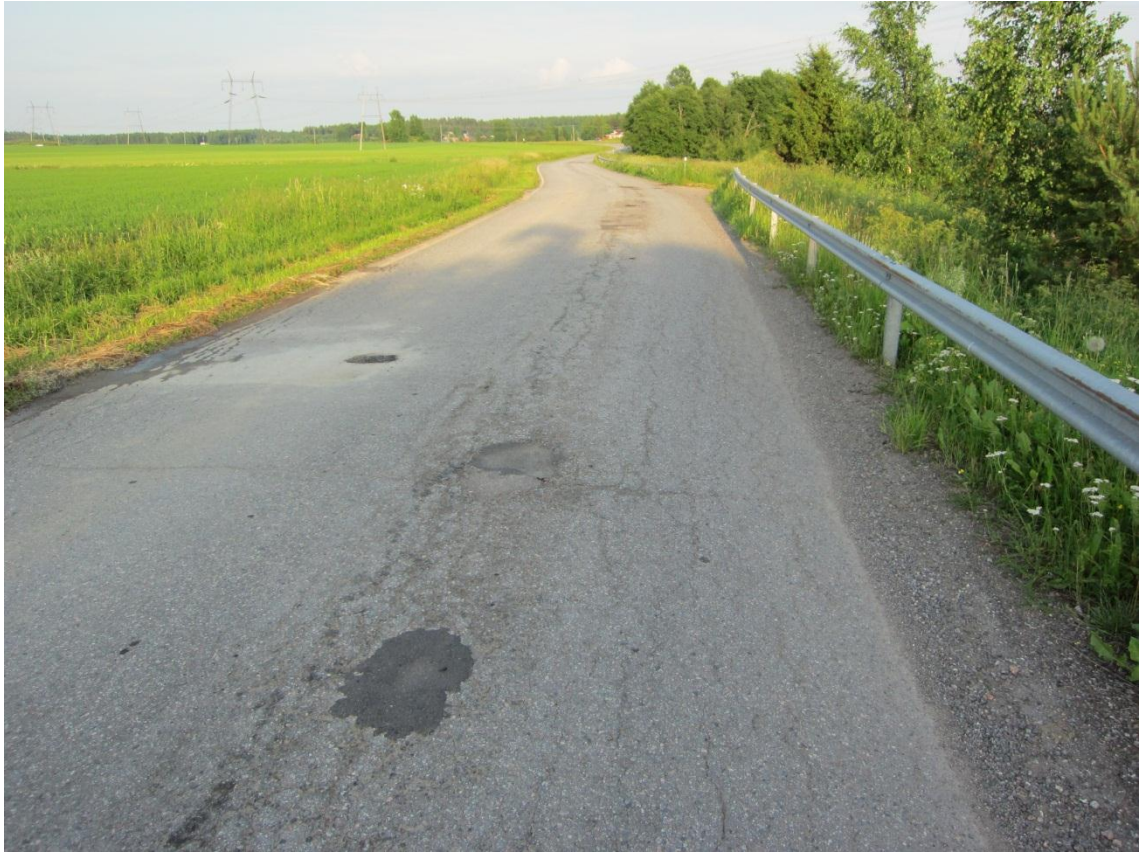
Kuva 6.6. Tyypillistä routavauriota tien 11146 paalulta 770, nollapaalun suuntaan.
