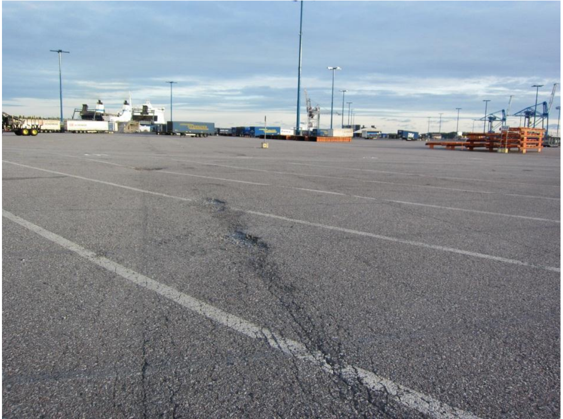
Kuva 6.55. Vuosaaren satamakentällä 2013 havaittu vaurio putkilinjan kohdalla
