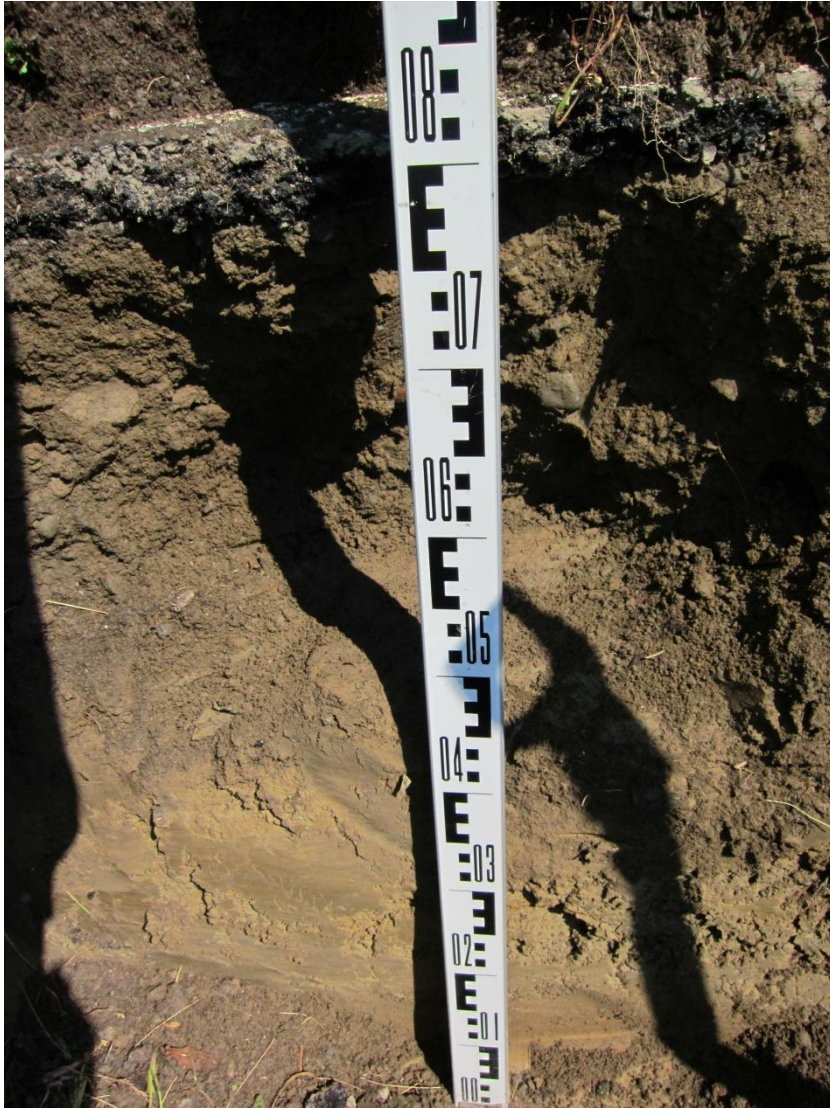
Kuva 6.9. Paalulle 910 vasempaan luiskaan tehty koekuoppa. Mittakaavana mittalatta, jossa numeroasteikko 100 mm välein. Päälyysrakenteen paksuus noin 300 - 400 mm.
