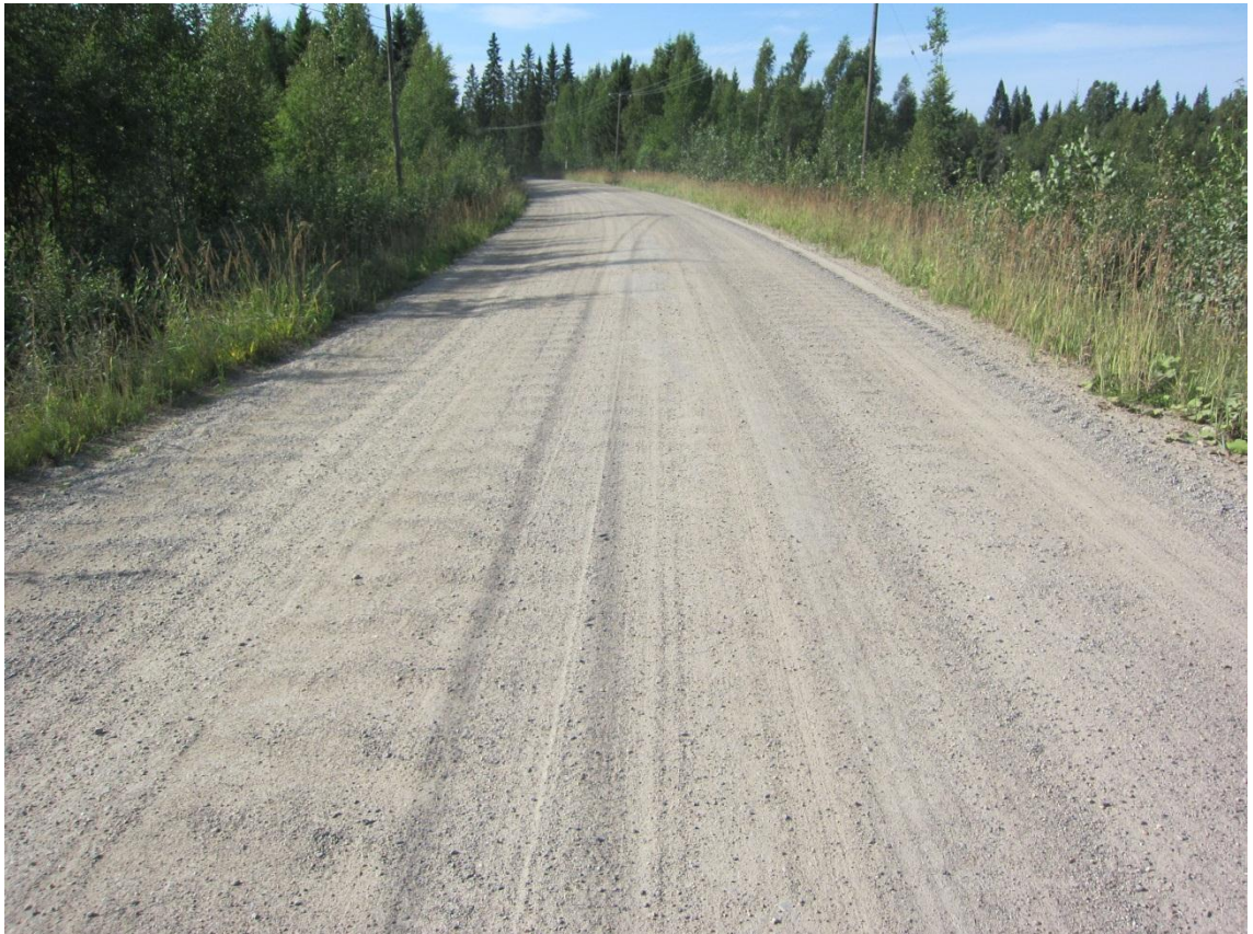
Kuva 6.44. Kuiva ja herkästi pölyävä tienkohta Leppävirralla tiellä 5341 paalulla 1200 massiivituhkarakenteen alueella
