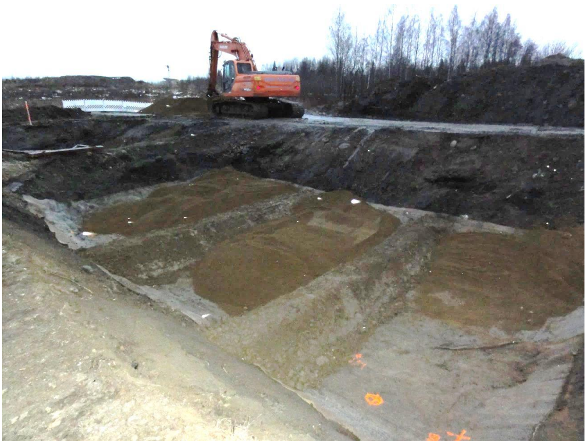
Kuva 8.5. Altaan 1 pohjalle asennettiin bentoniittimatto sekä rakennettiin patopenkereet savesta. Patopenkereiden välit täytettiin suodatinhiekkalla.
