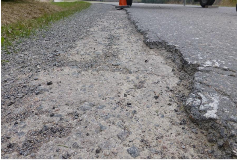
Kuva 28. Stabiloidusta kantavasta kerroksesta irronnut päällyste (17.5.2017, Ilari Harju).
