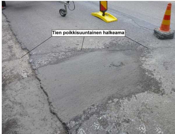
Kuva 21. Stabiloidun kantavan kerroksen halkeaman heijastuminen päällystehalkeamaksi Teuroisten koerakennuskohteella (17.5.2017, Ilari Harju).
