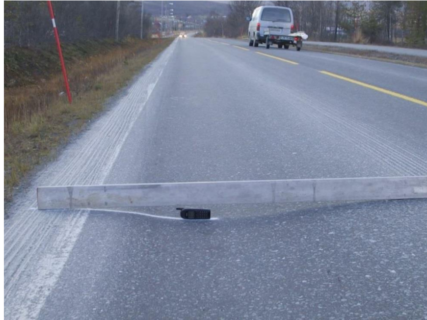
Kuva 3.15 Pohjamaan muodonmuutoksista aiheutuvaa laakeaa päällysteen urautumista (Saarenketo, 2014)
