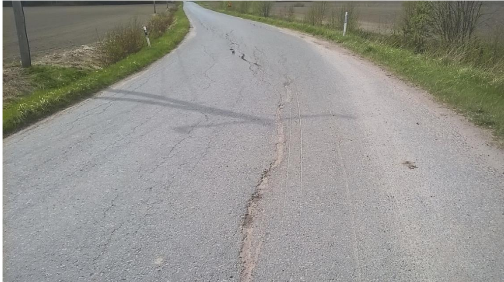
Kuva 3.12 Routahalkeama tien keskellä (Elina Lätti 2015)
