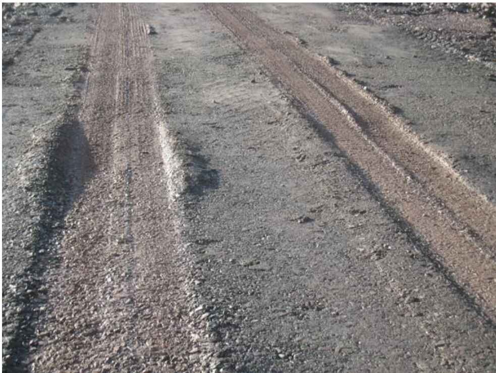
Kuva 3.13 Kulutuskerroksen tiivistymisestä ja sitomattoman kerroksen deformaatiosta aiheutuvaa urautumista sorapintaaisessa tierakenteessa (Roadex e-Learning)
