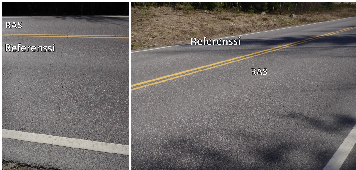
Kuva 45. Koekohteessa 1 havaittu poikkihalkeama.
