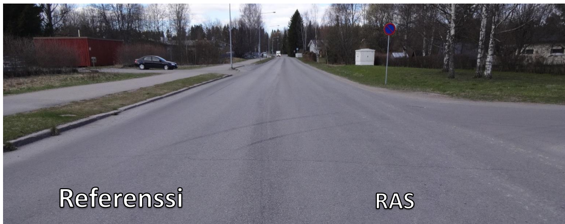
Kuva 52. Toinen koekohteessa 7 havaittu koko kadun levyinen halkeama.
