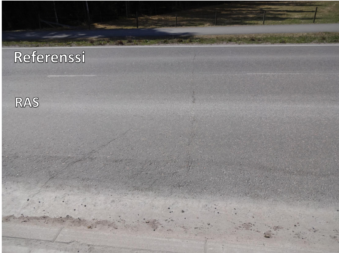
Kuva 48. Koekohteessa 6 havaittu halkeama, joka on kuvassa 49 esitetty tien suuntaisesti.
