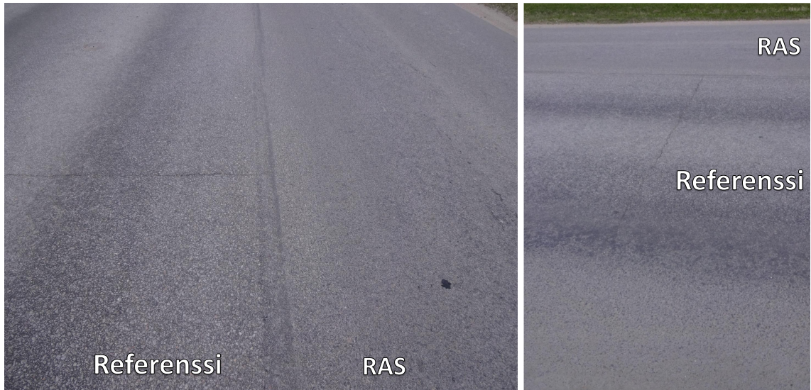
Kuva 33. Koekohteessa 7 havaittu halkeama, joka oli vain referenssimassan puoleisella kaistalla.
