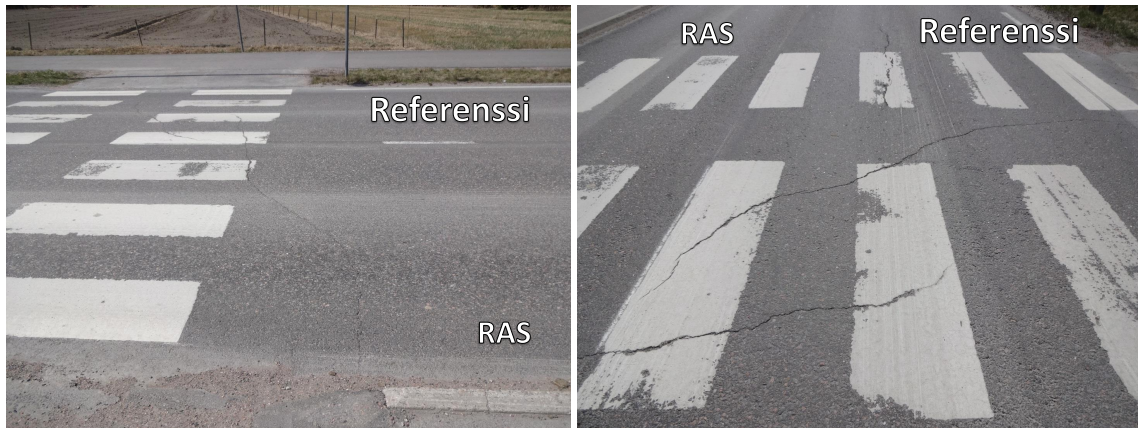
Kuva 50. Koekohteessa 6 havaittuja halkeamia.
