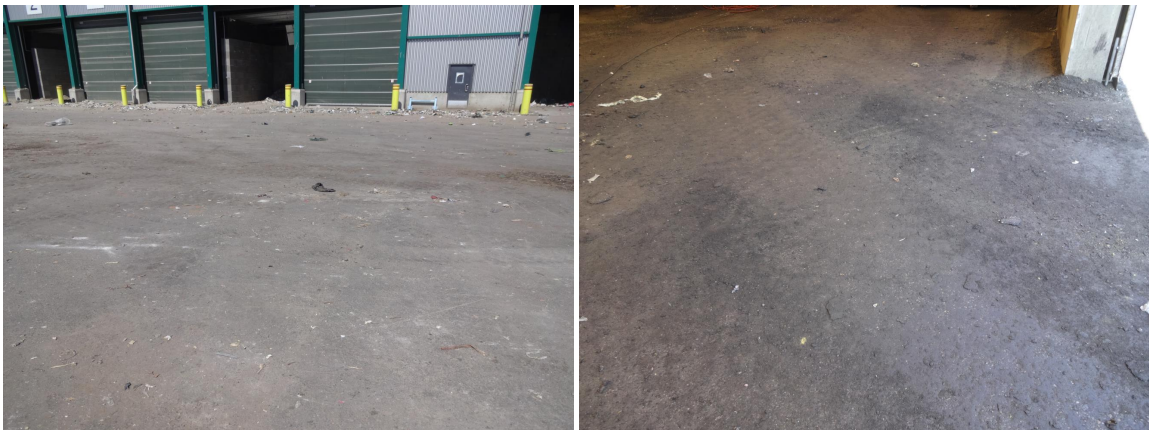
Kuva 29. Koekohteen 4 bitumikaterouhetta sisältävät päällysteet, vasemmalla kiinteistön piha-alueella oleva ja oikealla kevytrakenteisen hallin pohjana toimiva päällyste.
