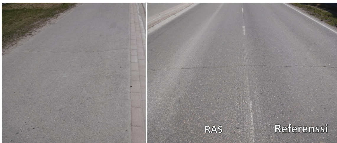
Kuva 49. Koekohteessa 6 havaittu halkeama, joka ulottui jalkakäytävälle asti. Esitetty kuvassa 48 sivusta kuvattuna.
