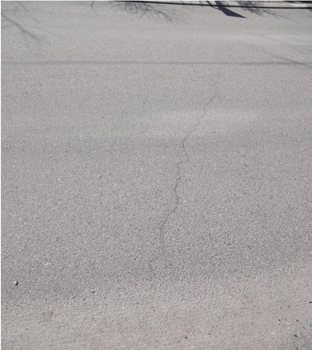
Kuva 54. Koekohteessa 8 havaittu toinen halkeama.
