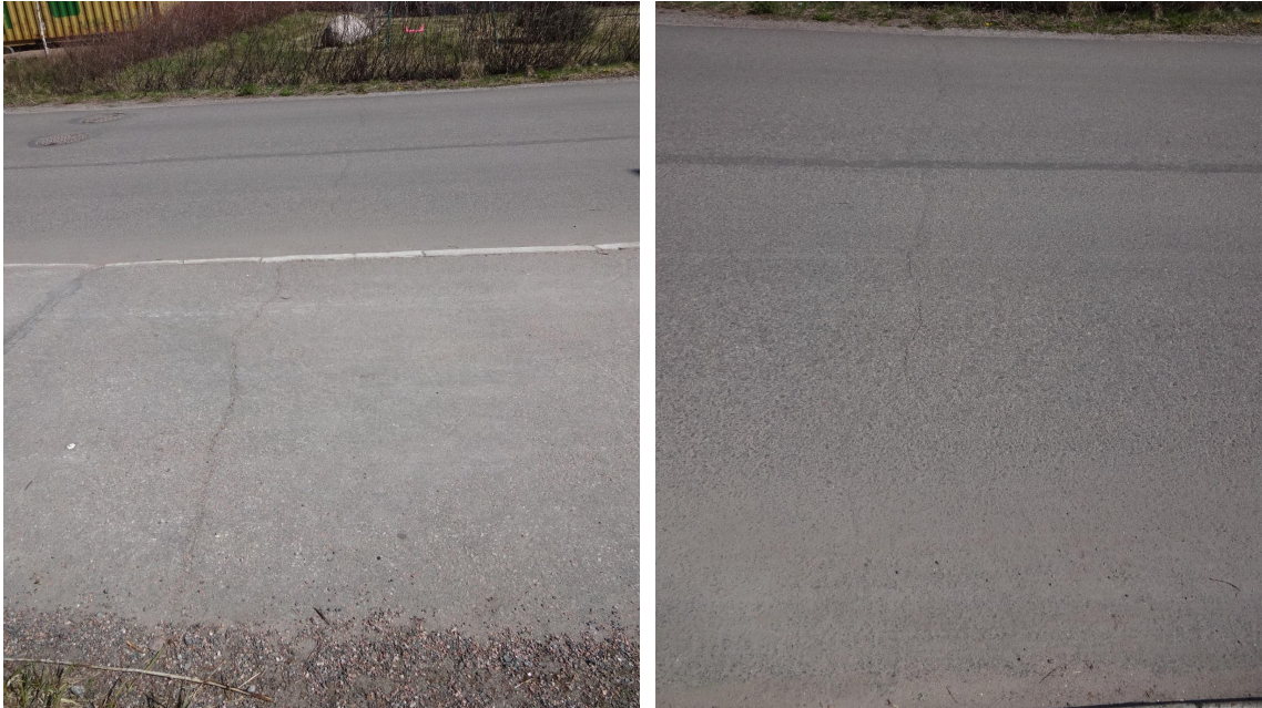
Kuva 53. Koekohteessa 8 havaittu halkeama, joka ulottui viereiselle jalkakäytävälle.
