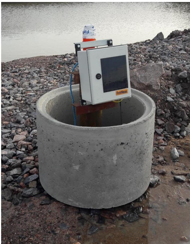
Kuva 9. Kaivonrenkaalla suojattu automaatti-inklinometriputki sekä mittalaitteen keskusyksikkö (Kuva: Forsman 15.2.2019).
