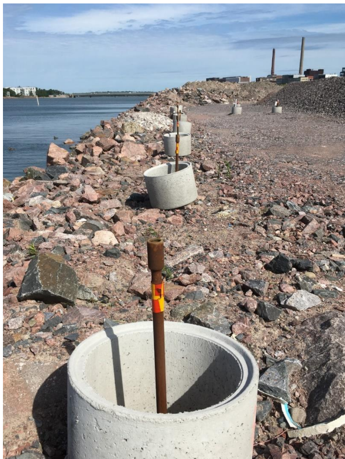
Kuva 10. Rantaluiskan yläreunaan asennetut siirtymäseurantatangot (Kuva: Anttila 12.6.2019).
