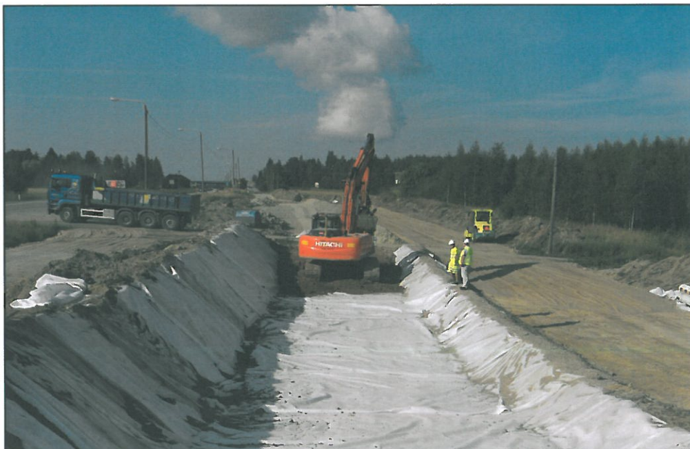
Kuva 4. Meluvallin rakennuskohde, jossa näkyy kaukalarakenne ja alla oleva suodatinkangas. Tuhkan siirtely ja tiivistäminen tehtiin kaivinkoneen avulla.
