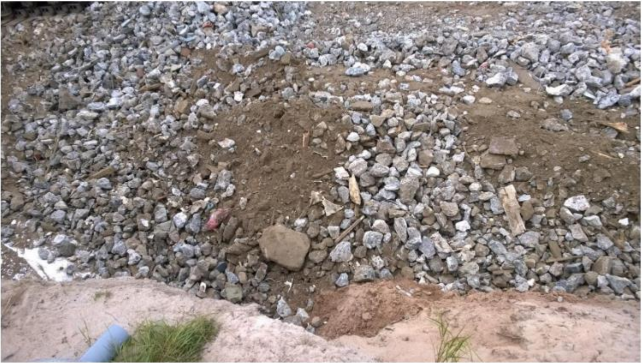
Kuva 11. Betonimurskerakenteeseen jääneitä epäpuhtauksia, maa-ainesta ja kameja. [Lähde: Kipsitien koerakenteet. Seurantaraaportti]
